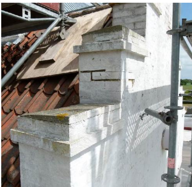
Våbenhusets tykke cementpudsafdækninger vor i god stand – en enkelt revnet og løsnet
