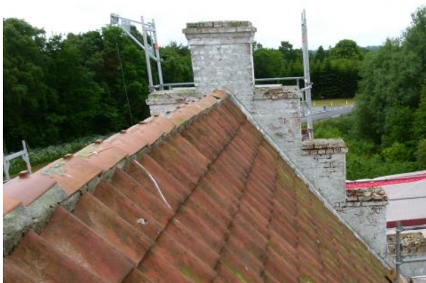
Rygningen havde løs mørtel og flere revnede sten.
