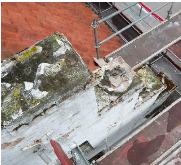
Kun få afdækninger i cement holder. Når pudsens revner trænger vans in, og der kommer frostsprængninger, ofte også i murstenene.
