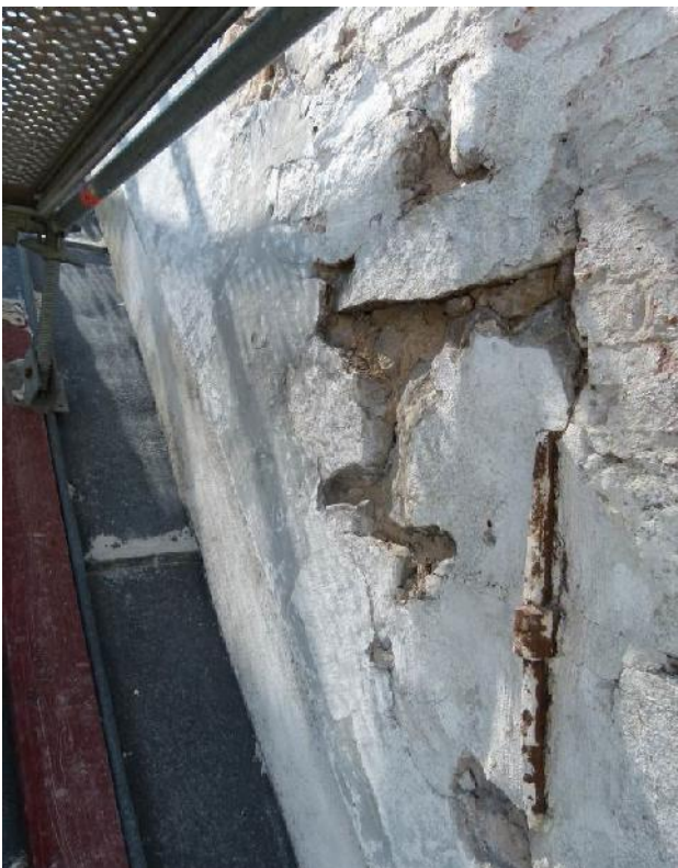
Østgavlen. Store tykke lag af cementmørtel. Murankeret, der hører til den gamle del af tårnet, har forbindelse til nordsiden store muranker.
