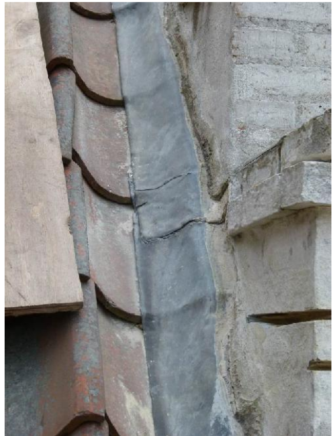
Revnet blyvinge og defekt lodning. Fugningen i den fræsede rille er repareret med fugemasse – burde være mørtel.
