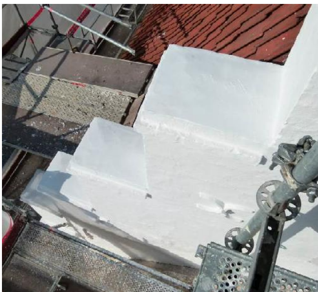
De færdigt afdækkede og kalkede kamtakker. Der er lidt ”ryg” på afdækningen, så vandet løber af.
