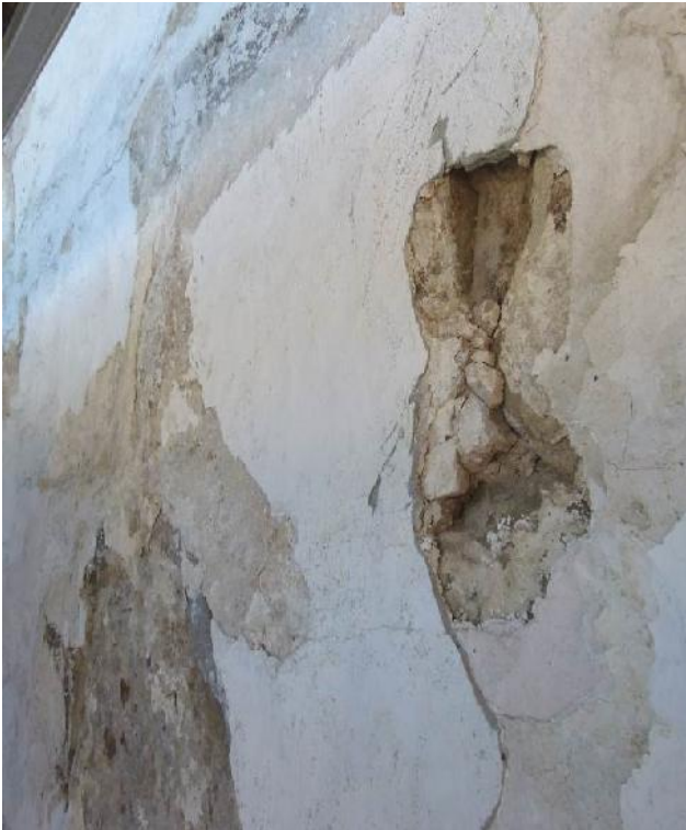
Nordsiden. Flere tynde cementpudslag udenpå, der ofte hæfter godt på underlaget.
