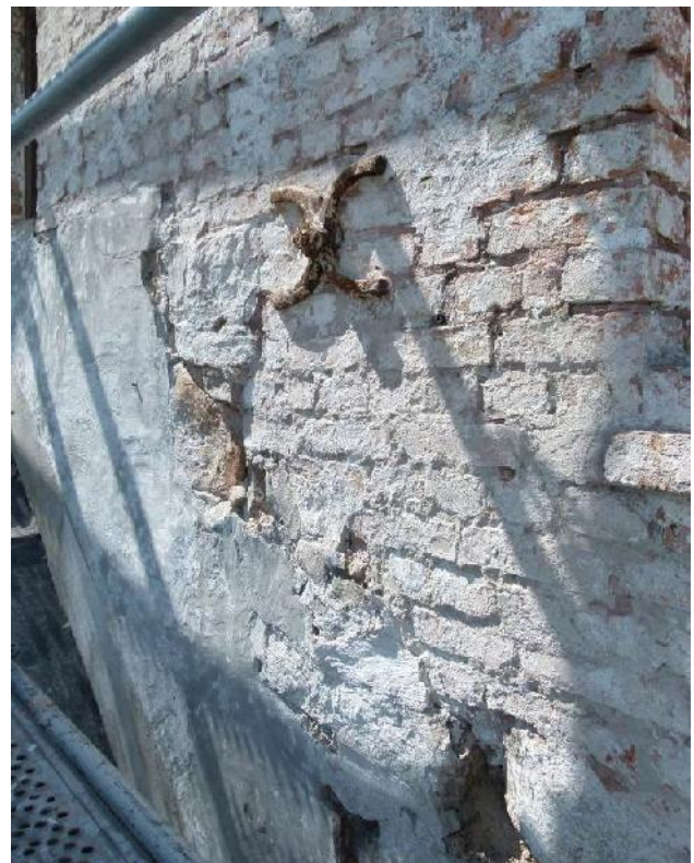
Her gav man op – lod cementpartiet sidde – for meget ville blive ødelagt ved udhugning. Murankeret hører til ommuringen med mursten i 1850-erne, hvor kamtakkerne kommer til.
