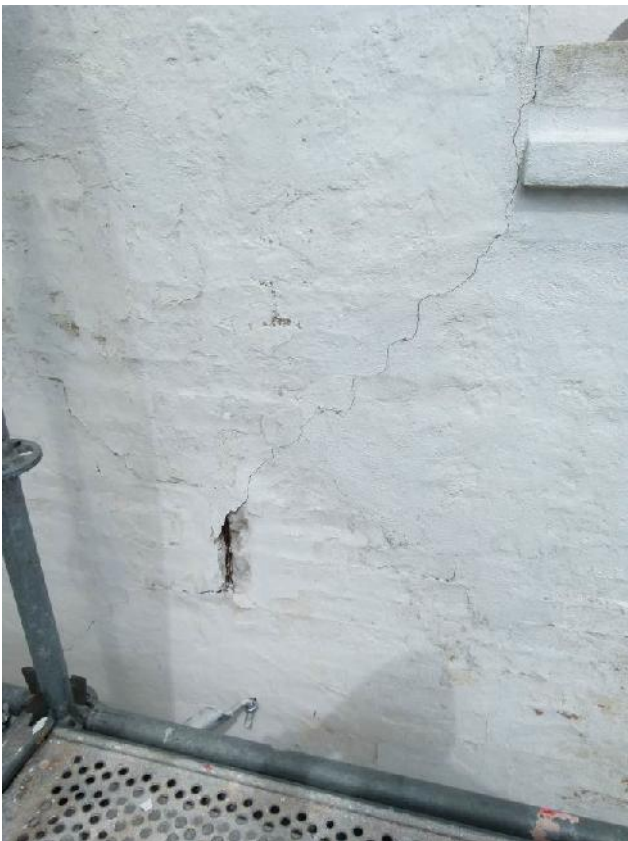
Fra jernankrene "stråler" revner ud i murværket, som følge af rust-udvidelser.
