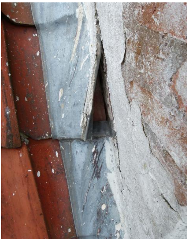
Revner og løse lodninger. Blyet var lagt i en fræset rille i murværket.
